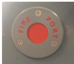
Feuerlöschöffnung auf der Backbordseite der Konsole
